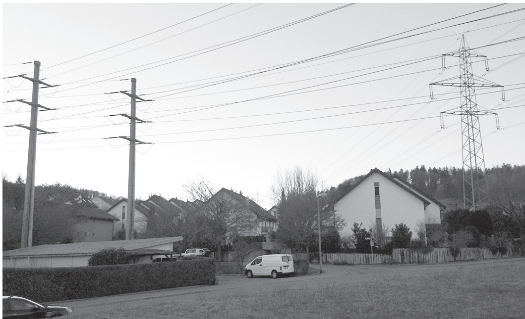
Blick auf die Hochspannungsleitungen an der Verzweigung Hündlerstrasse/Bergackerstrasse.
